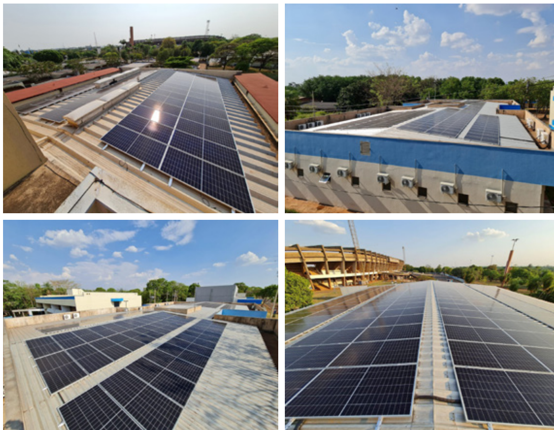
Placas fotovoltaicas instaladas nos Setores 1, 2 e 3 da Cidade Universitária
