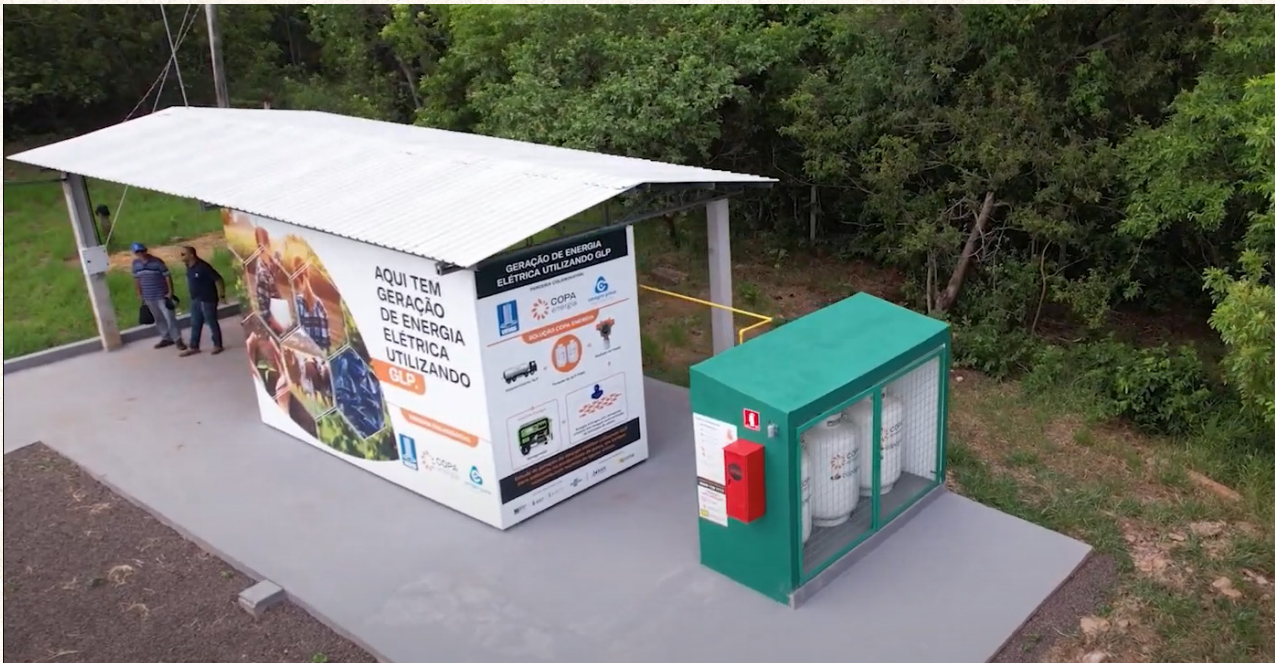
Imagem 8. Fontes de energia renovável ou menos poluentes na UFMS: placas solares fotovoltaicas, usina de hidrogênio verde, reatores a biodiesel e geradores a gás GLP
